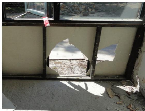
Vægplader med asbest
