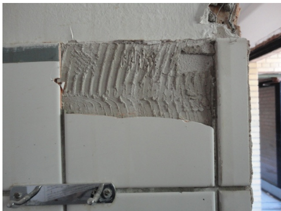
Fliseklæber med asbest
